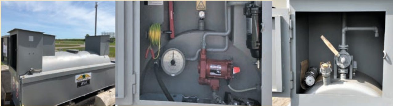
Cistern med "kjol" och miljölåda
