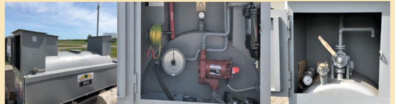
Cistern med "köl" och miljölåda
