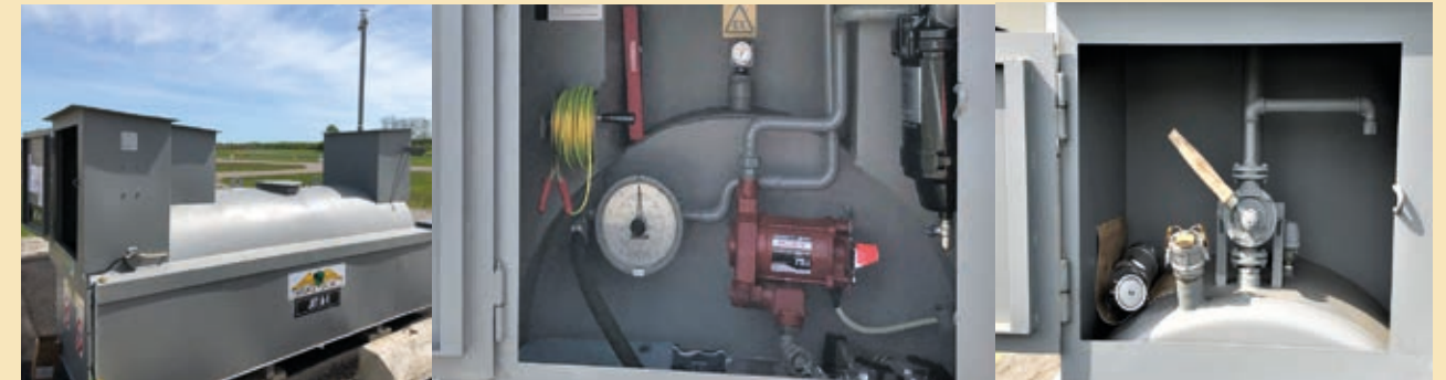
Cistern med "köl" och miljölåda
